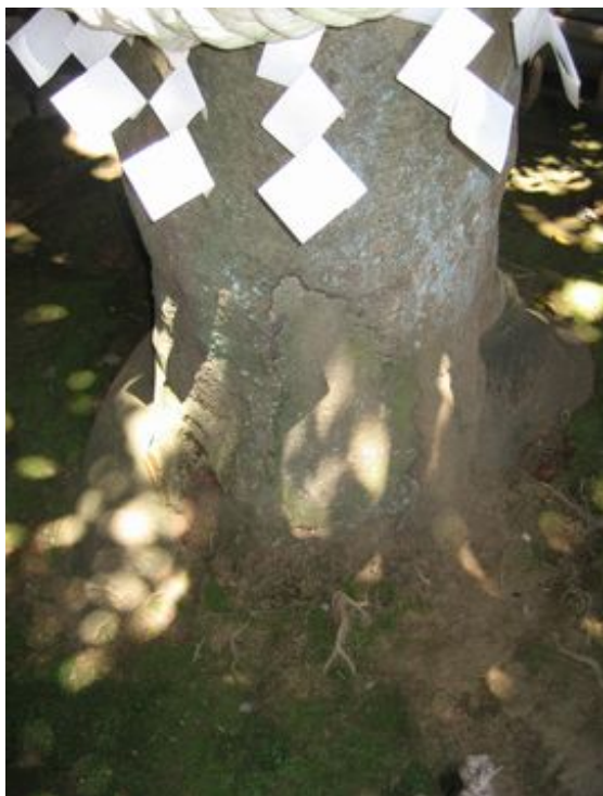
・根元の傷跡にモルタルが充填されている(南側)
